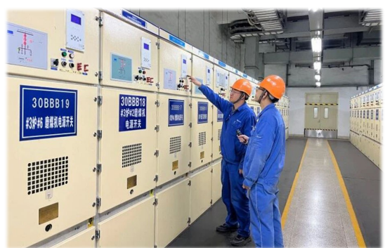
对开关设备集控巡检
